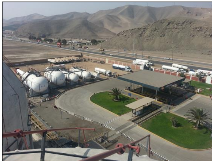
Foto N° 2.7.2-c. Tanques horizontales e isla de carga
