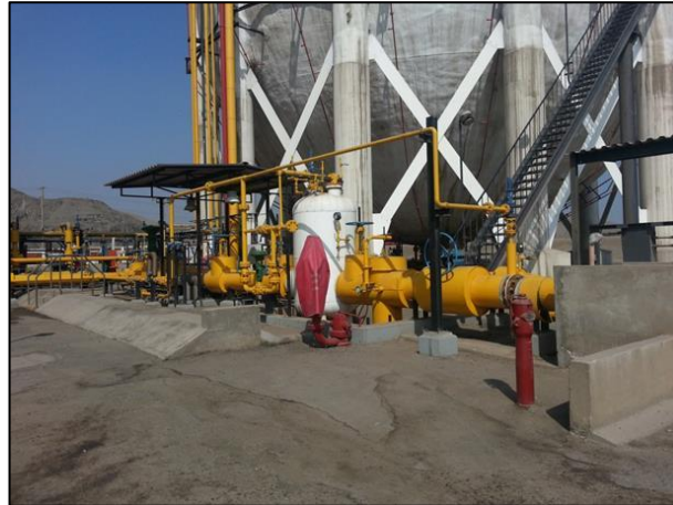
Foto N° 2.7.2-a. Línea de recepción de buque a esferas
