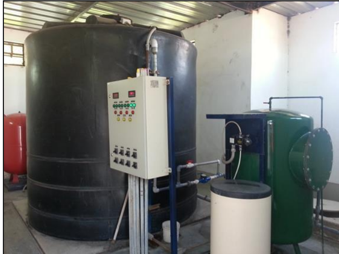
Foto N° 5.2.2.3.B-1. Planta de tratamiento – Equipos
