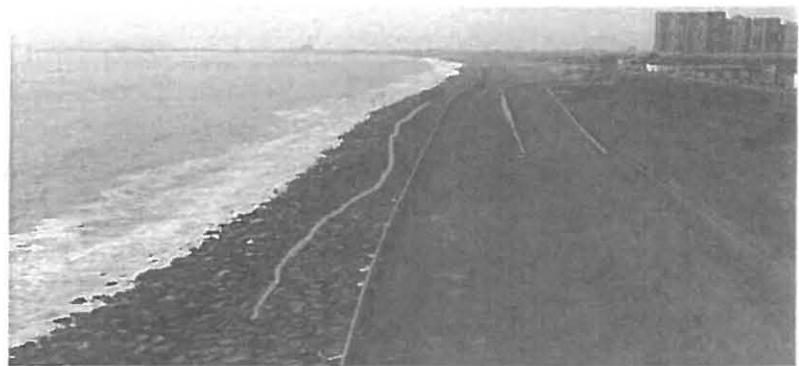
Figura 4. Vista fotográfica de la geometría de la escollera que no ha sido cubierto por canto rodado (altura del viaducto Santa Rosa)
