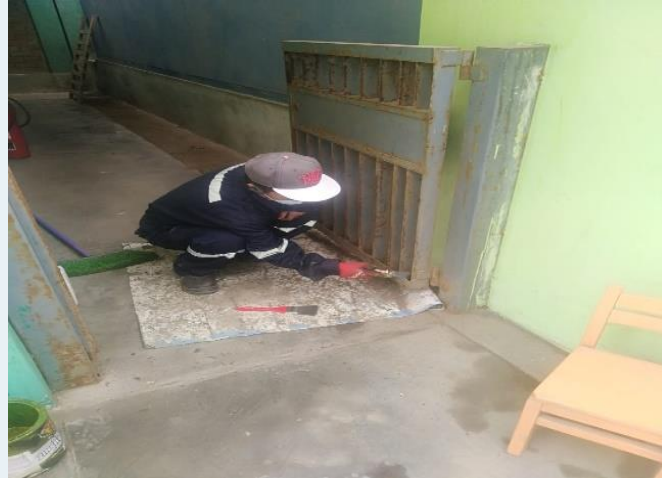
Antes: Estructura metálica sin mantenimiento
