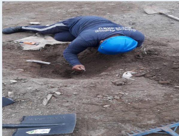
ANTES: POZO A TIERRA DETERIORADO
