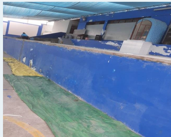
ANTES: Estrado en mal estado
