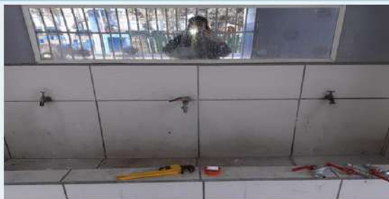
ANTES: Caños de lavaderos en mal estado
