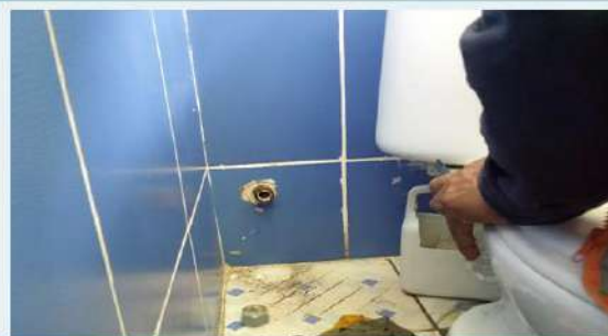
ANTES: Instalaciones sanitarias en mal estado
