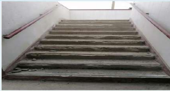
ANTES: Escaleras en mal estado
