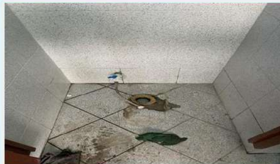
ANTES: Instalaciones Sanitarias, en mal estado
