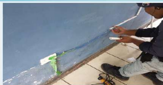
ANTES: Canaletas en mal estado
