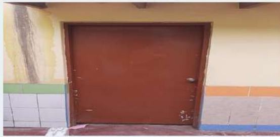
Antes: puerta de madera sin barnizar y deteriorada
