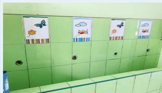
ANTES: Lavadero sin griferías
