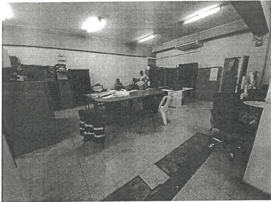
Figura 14: Estado Actual del espacio donde se va a desarrollar la adecuación. Elaboración propia.
