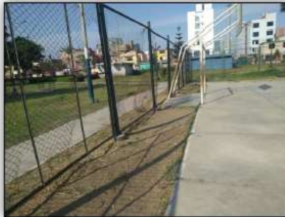
Figura N° 9 Malla metálica deficiente, Loza del Parque La Amistad
